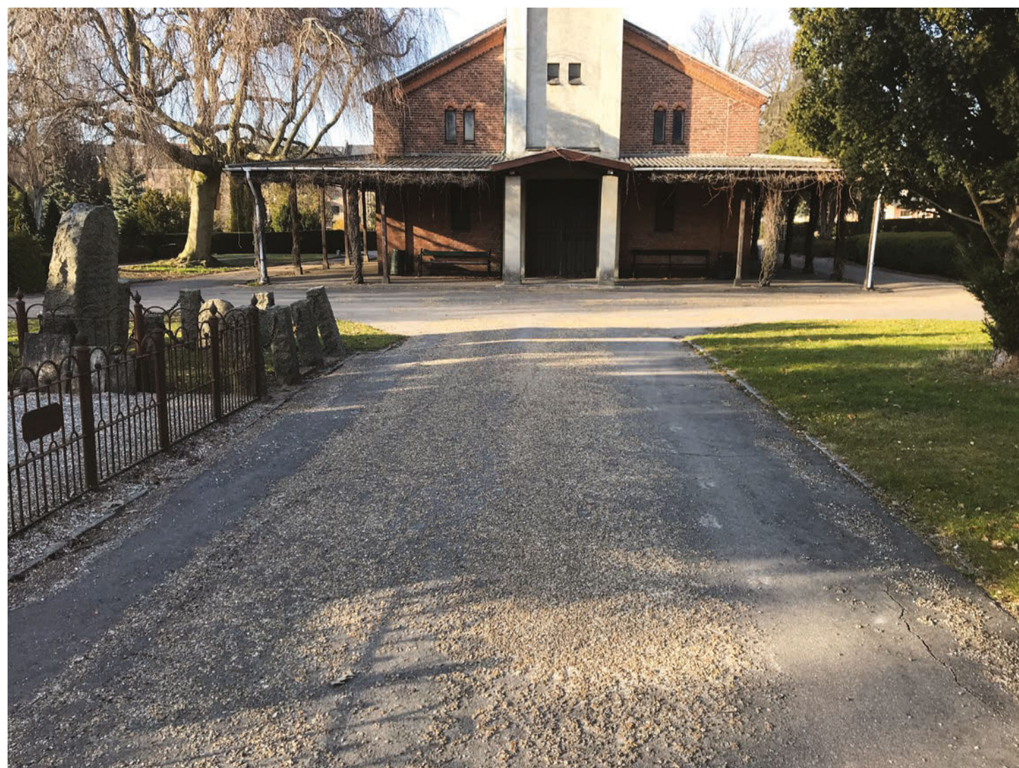
Hovedstien mod kapellet. Den er udlagt i asfalt med et bærelag af OB-belægning, som næsten er slidt af.
